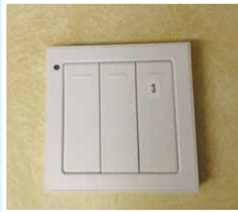
المفتاح الكهربائي الثلاثي
