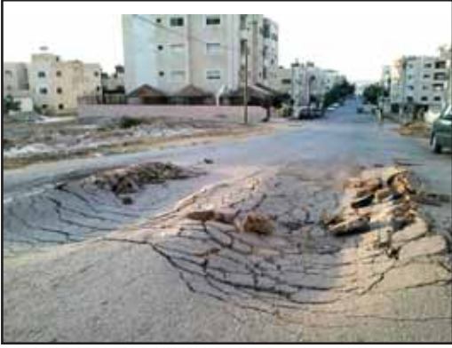
الشكل (٦-١): عدم صلاحية الطريق.
